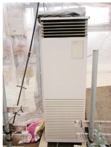
カーネーション栽培でのヒートポンプ設置事例
