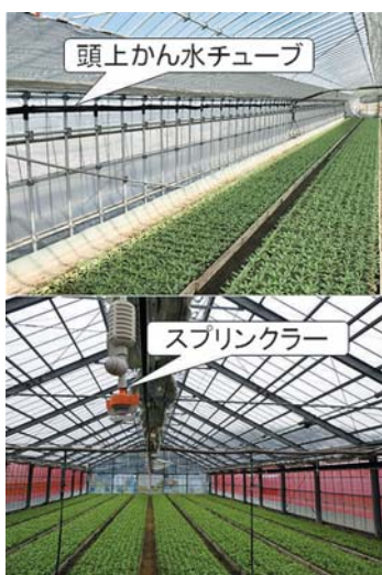
図：ストック栽培温室に導入された頭上かん水設備
